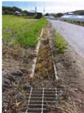
埋まってしまったU字溝(上地区)
