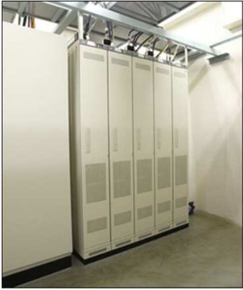
基地局無線設備
