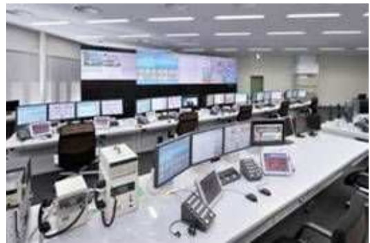
消防管制システム
