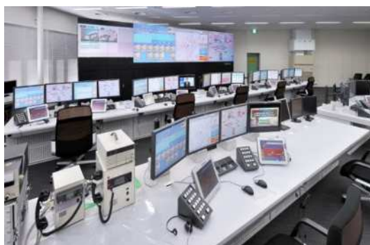
消防管制室の状況
