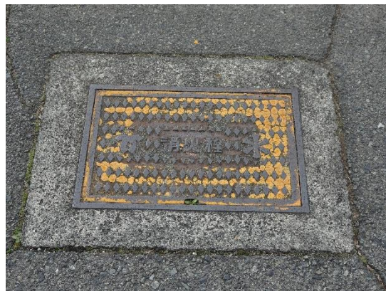
地下式消火栓
