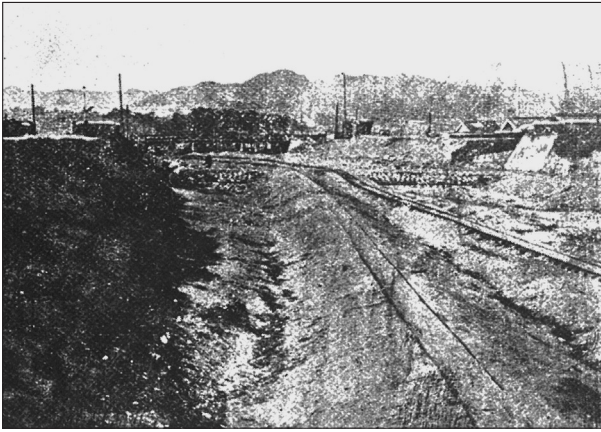
▲埋立工事中の湊川(東川崎町より上流を望む) (「区誌生田いまむかし」P69より)
